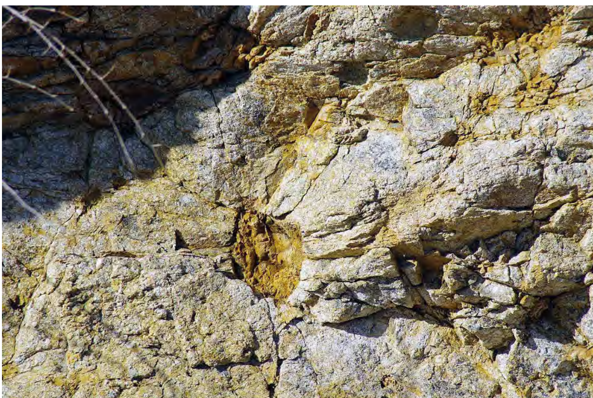
Kamenná slunce, která byla zachována na korodující čelní stěně ještě 15. 2. 2017
