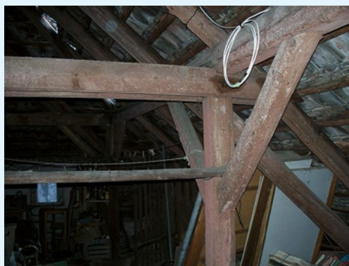
Původní konstrukce krovu brání vestavbě
