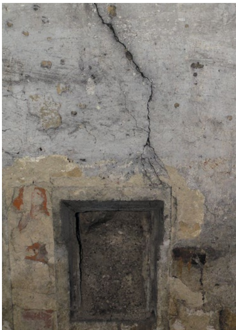
Obrázek 2.2 Trhлина v komínovém zdivu
