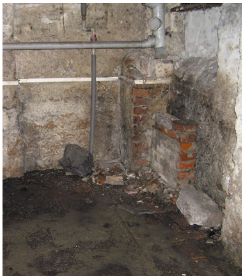
Obrázek 2.3 Průsak vody do suterénu
