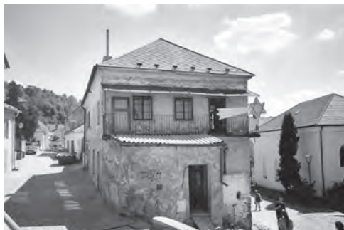
Obr. 1.14 Kombinované závady, vzniklé vztlínáním a volným zatékáním
