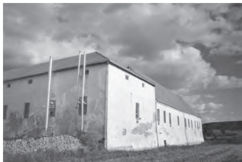
Obr. 1.15 Vztlínající vlhkost dosahuje často i více než 6 m výšky u obvodových zdí, přestože se jedná o prudce osluněné západní průčelí
