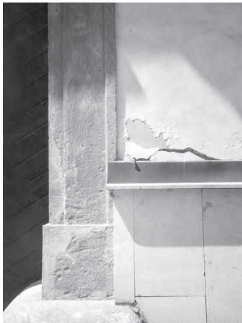
Obr.1.19 Vadně provedený sokl, který zdivo utěšňuje a je příčinou kumulace vody v nosném zdivu
