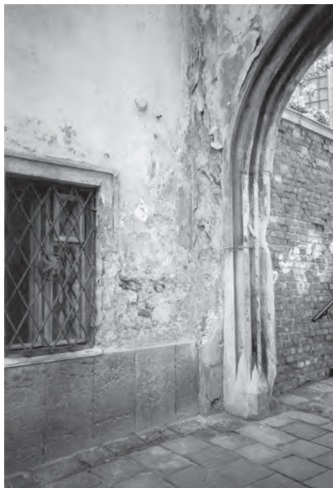
Obr. 1.12 Vlhkost se do zdiva dostává „knotovým efektem“ v místě křížení příčné stěny s fasádou
