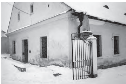
Obr. 1.16 Voda se do zdiva dostává také vlivem atmosférických srážek, sněhu apod., tj. nevhodnými stavebními detaily
