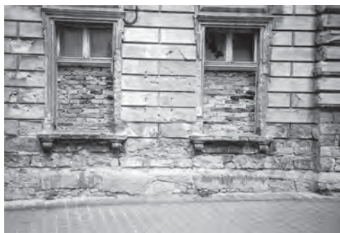
Obr. 1.11 Charakteristické vztlínání vody z podzákladí zapříčiněné také zazděnými okny suterénu
