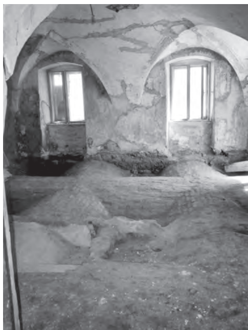
Obr. 1.20 Vlhkost zdiva a všech povrchů v interiéru je kombinací příčin a má vliv i na stabilitu objektu
