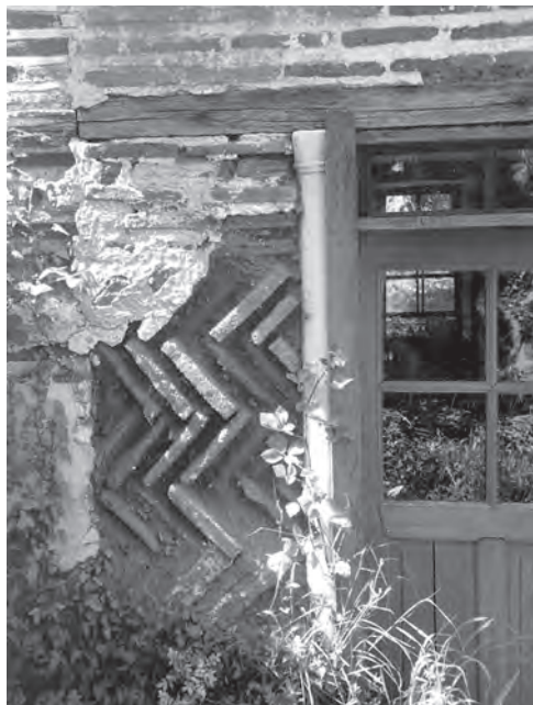
Obr. 1.18 Degradace zdiva je zvlášť hluboká u hrázděných objektů, kde se jedná o zdivo výplňové
