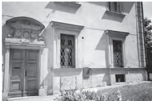
Obr. 1.13 Fasáda domu degradovaná vlivem druhotného vztlínání
