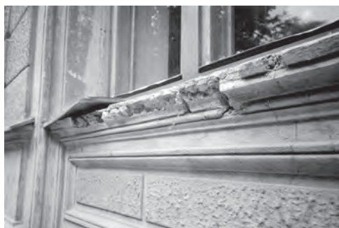
Obr. 1.17 Nevhodný detail oplechování, který je příčinou volného zatékání a destrukce římsy
