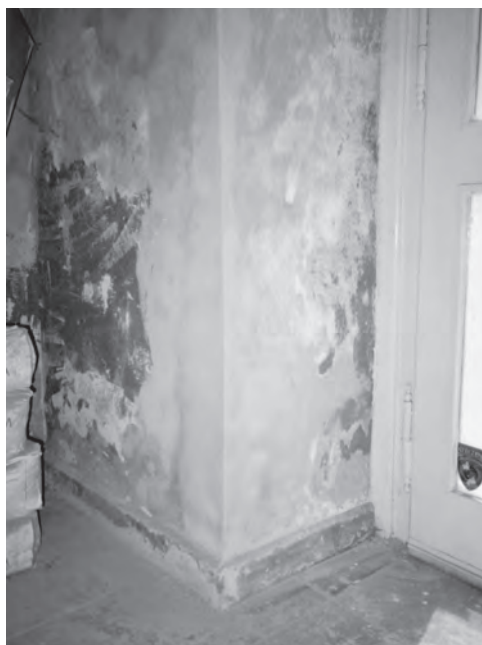
Obr. 1.21 Vlhkost stěn vytváří podmínky pro výskyt plísní, hub
