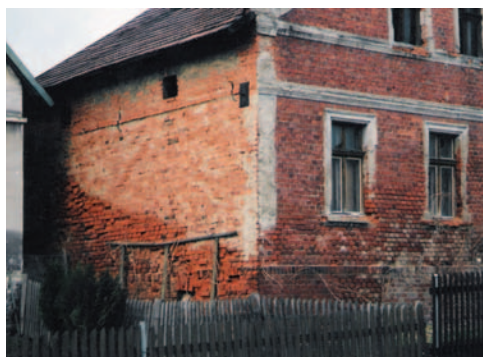
Obrázek 2.7 Zvětrání cihelného zdiva následkem povětrnostních vlivů
