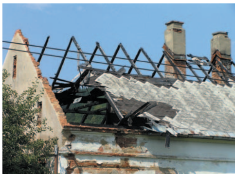
Obrázek 2.14 Destrukce objektu následkem požáru
