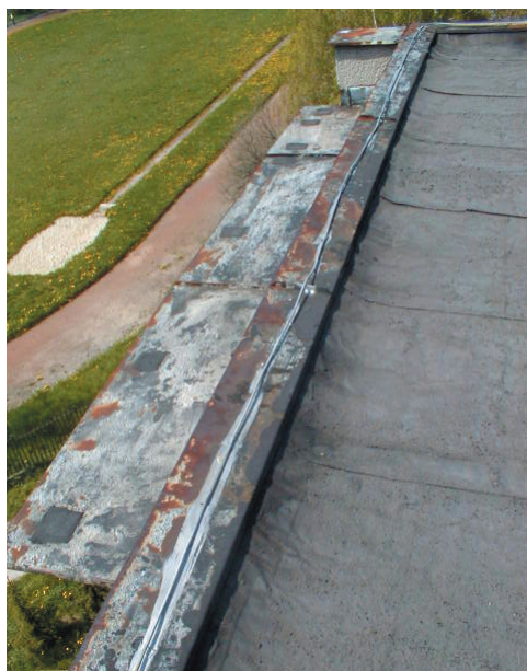
Obrázek 2.9 Koroze oplechování atiky zapříčiněná povětrnostními vlivy
