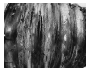
Poškozena pryžová manžeta [1]
