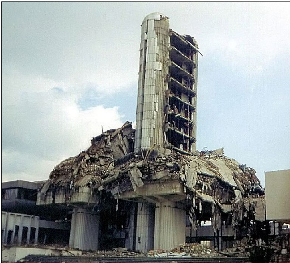
Ruiny budovy deníku Oslobodjenje Sarajevo (fotoarchiv autora)
