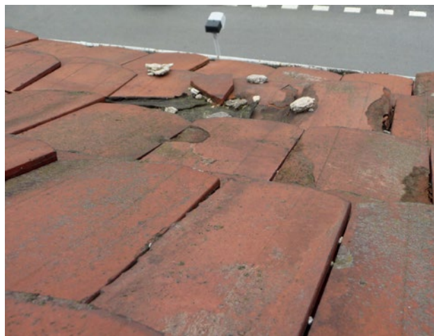
Poškozenou krytinu je třeba vyměnit
